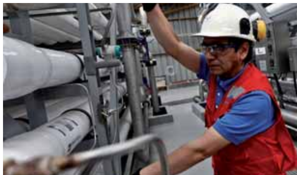
Planta de Osmosis inversa Copiapó
